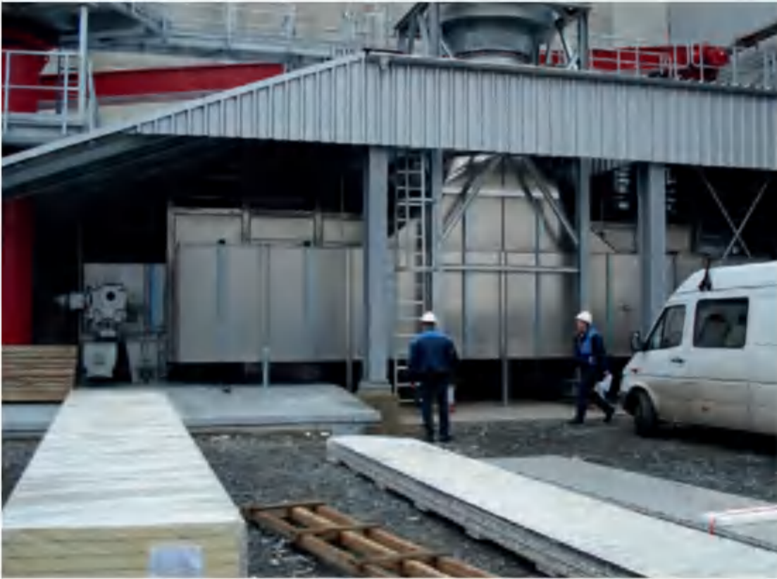
项目地: UET Choren, 德国 型号: BT 1/6200-12 安装年份: 2006 干燥物料: 木片 出料能力: 约4.5吨/小时 降水区间: 35%-10%含水率
