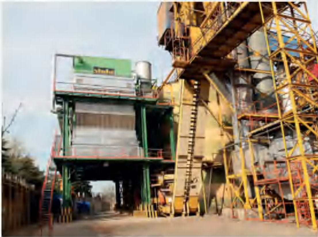
项目地: Starwood AS 土耳其 型号: BT 2/6200-22.5 安装年份: 2018 干燥物料: 木片 出料能力: 约12.8吨/小时 降水区间: 100%-1.5%绝对含水率
