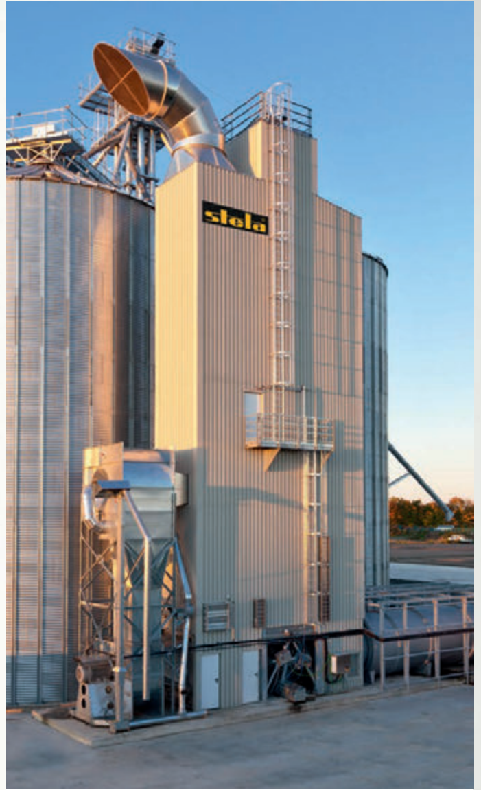
Agrargenossenschaft Schwinkendorf AG 德国, Moltzow OT Schwinkendorf 型号: GDB-XN 1/15-SU 安装年份: 2017年 干燥物料: 玉米, 小麦, 油菜籽 干燥能力: 玉米: 15.0吨/小时, 降水区间: 35%-15% 小麦: 50.0吨/小时, 降水区间: 19%-15% 油菜籽: 40.0吨/小时, 降水区间: 13%-9%
